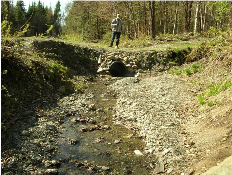
Figure 13. Bassin de sédimentation plein, en amont d'un ponceau
