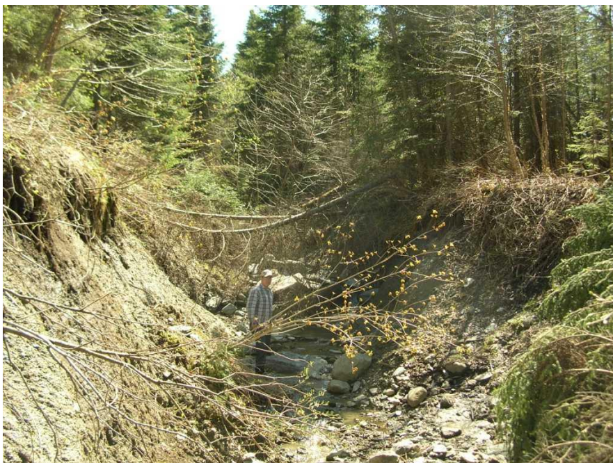
Figure 11. Canyon causé par le regroupement de 3 fossés et par la pente importante
