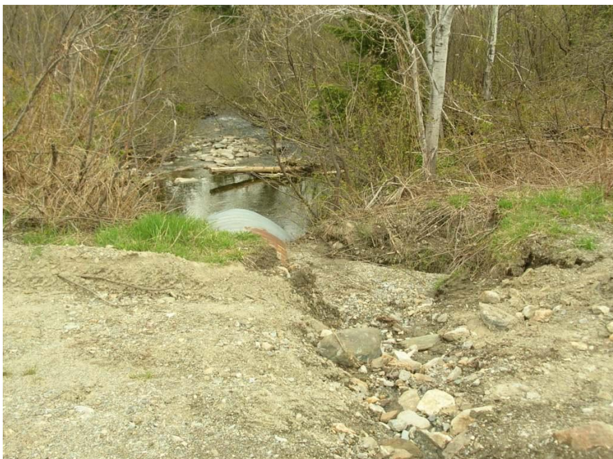
Figure 14. Signe d'érosion sur un chemin du à un ponceau inadéquat
